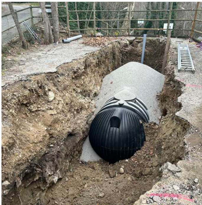
Récupérateur d'eaux de pluie installé à Gervanne camping
