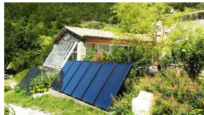
Panneaux photovoltaïques à l'Arche des 3 becs
