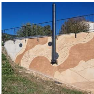
Chaudière à bois à l'Ancien Monastère de Sainte-Croix
