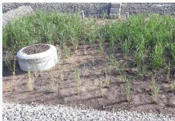
Système de phytoépuration au camping de la Clairette : l'intégralité des effluents sont biotraités par un filtre planté de roseaux
